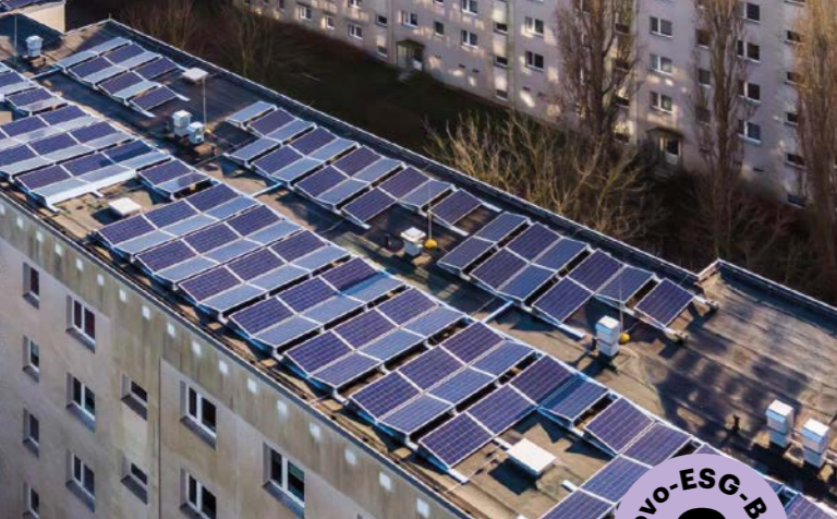
Photovoltaikanlagen in Kaulsdorf
